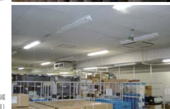
蛍光灯の間引きによる消費電力削減 (三木工場)
