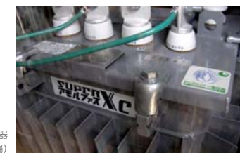
アモルファス変圧器 (三木工場)
